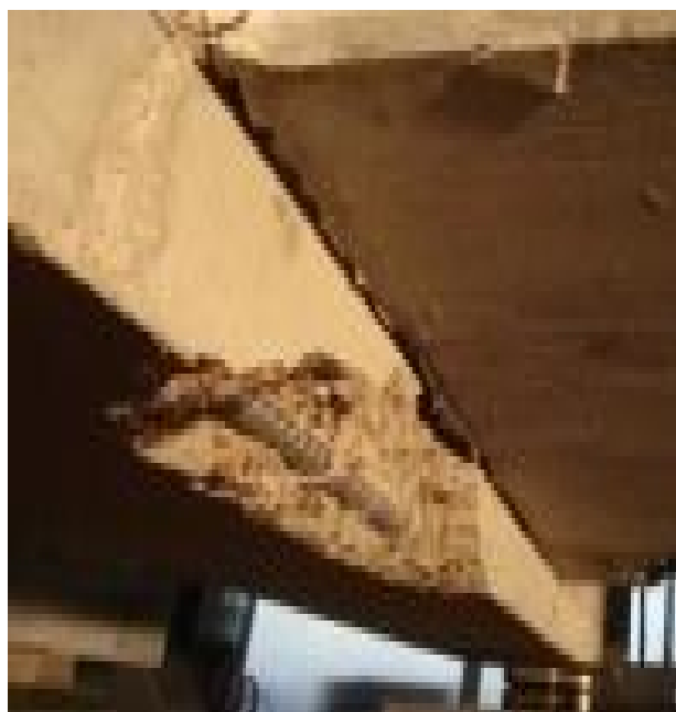
Photo 16 : Vue de dessous : fissure longitudinale à l'intrados entre la prédalle et la poutre ; éclatement du béton de la poutre
