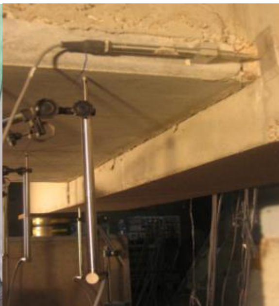
Photo 22 : Vue de dessous côté opposé : fissure longitudinale à l'intrados entre la prédalle et la poutre
