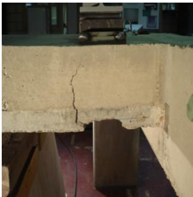
Photo 17 : Vue latérale : fissure en sous-face remontant l'épaisseur du plancher
