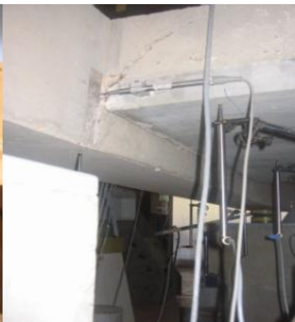
Photo 20 : Vue de dessous : fissure longitudinale à l'intrados entre la prédalle et la poutre
