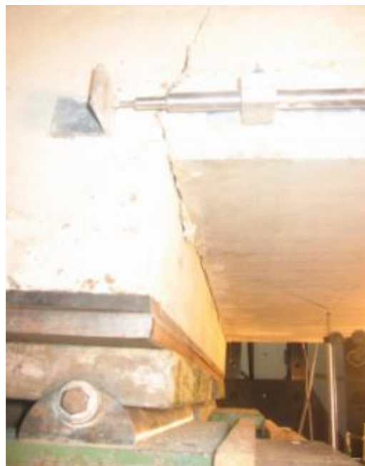
Photo 12 : Vue de dessous : fissure longitudinale à l'intrados entre la prédalle et le chaînage
