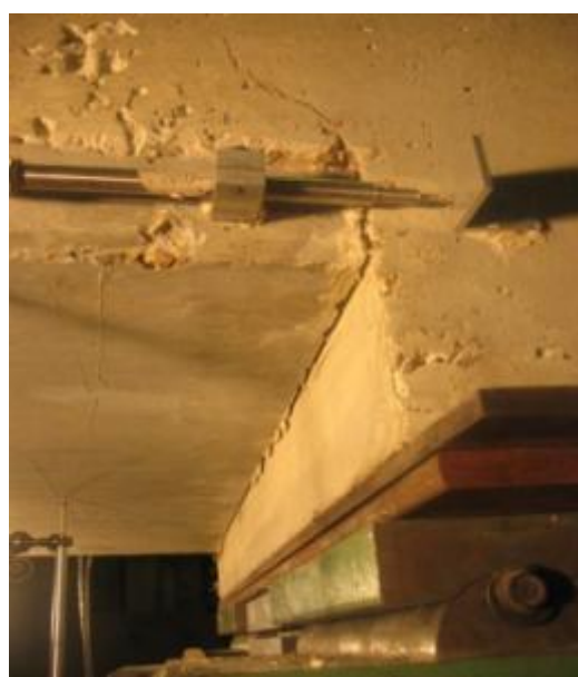
Photo 14 : Vue de dessous côté opposé : fissure longitudinale à l'intrados entre la prédalle et le chaînage
