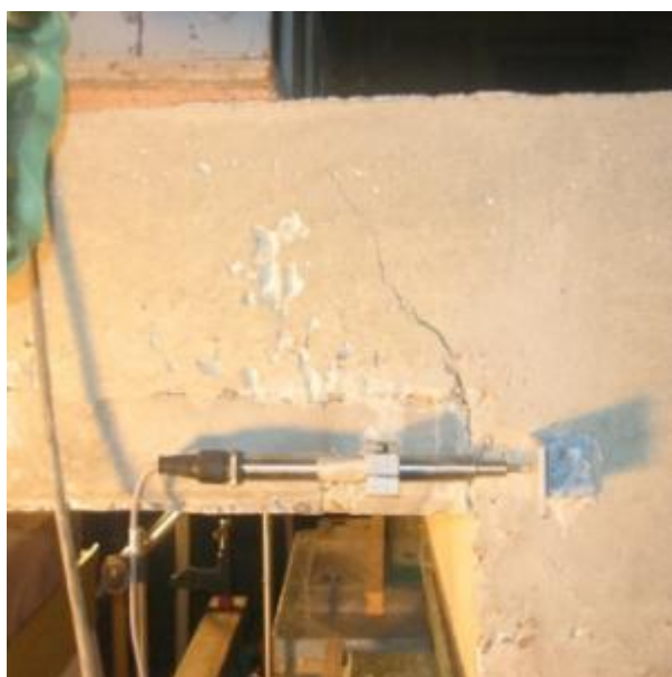
Photo 13 : Vue latérale opposée : fissure inclinée sur l'épaisseur du plancher
