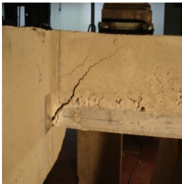
Photo 15 : Vue latérale : fissure inclinée sur l'épaisseur du plancher
