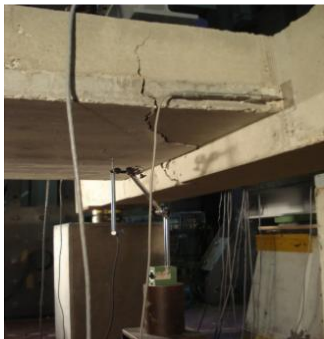
Photo 18 : Vue de dessous : fissure en diagonale en sous-face remontant l'épaisseur du plancher
