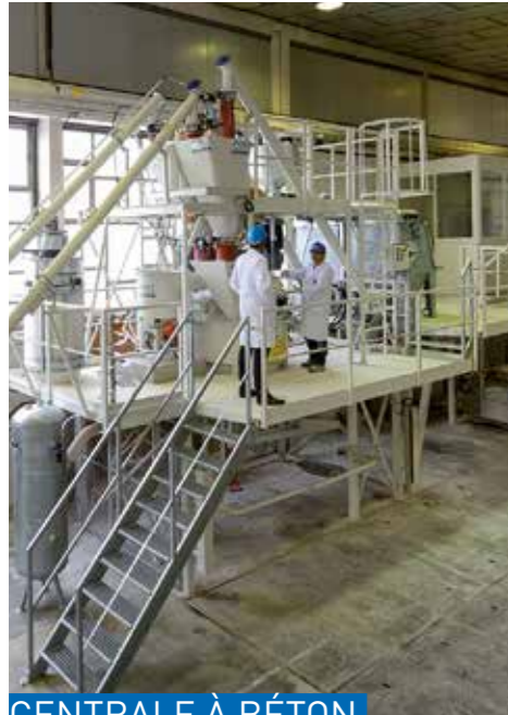
CENTRALE À BÉTON
